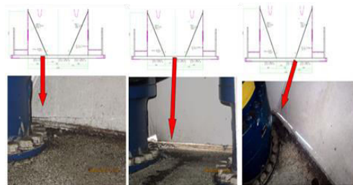
Gambar 2. Posisi Retak pada Slewing Tower Level Luffing Crane .
