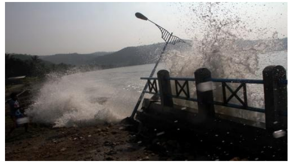
Gambar 5. Kerusakan infrastruktur Pantai Sine.
