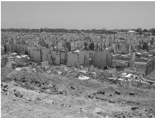
Gambar 1.2 : Sisa Perum TAS yang sempat dibongkar
