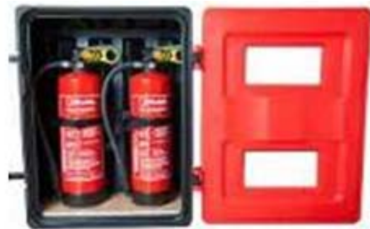
Gambar 16. Apar Diletakkan 1 Tiap Ruang
