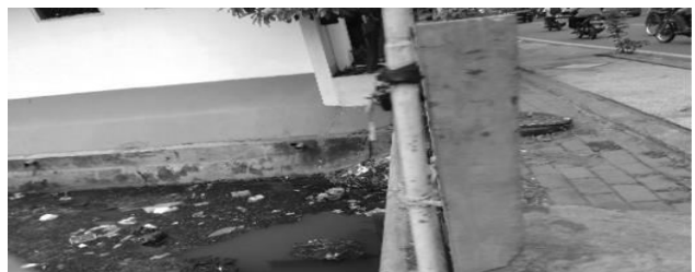
Gambar 3. Gambar kondisi drainase pada tapak.
