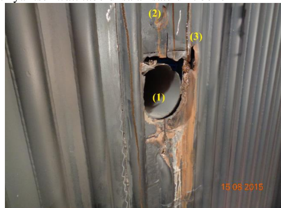
Gambar 1. Riser wall tube yang mengalami kegagalan
