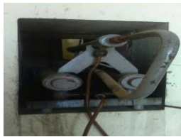
Gambar. 3. Kompor Kremasi Krematorium Keputih (Sumber: Hasil Dokumentasi Survey)
