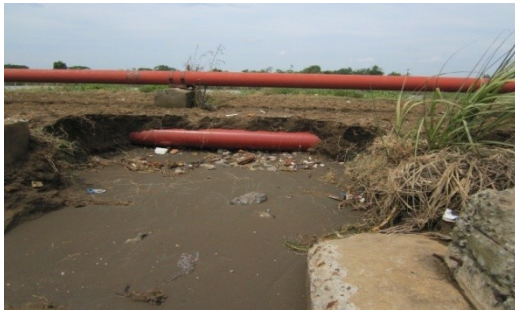
Gambar. 3. Pengaruh abrasi pantai terhadap pipeline.
