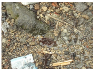
Gambar 2. Kebocoran di Dusun Laharpang
