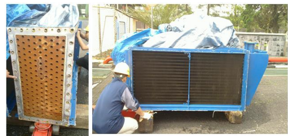
Gambar 2 Generator Cooler di Pembangkit Listrik Tenaga Panas Bumi.
