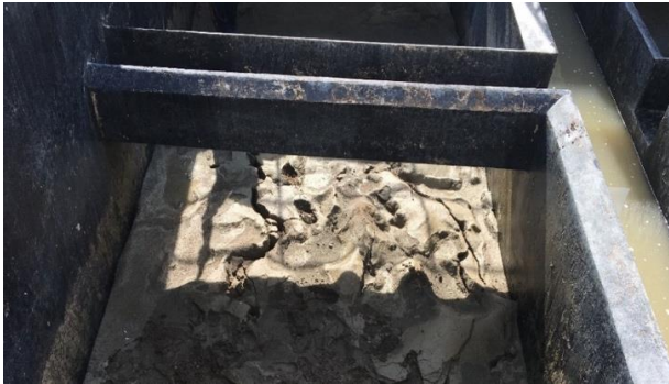
Gambar 6. Filter Channeling pada Media Unit Filter.
